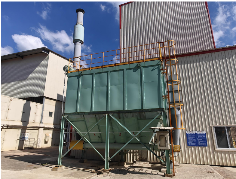
废气处理设施
