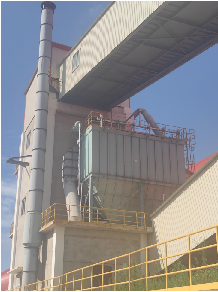
废气处理设施
