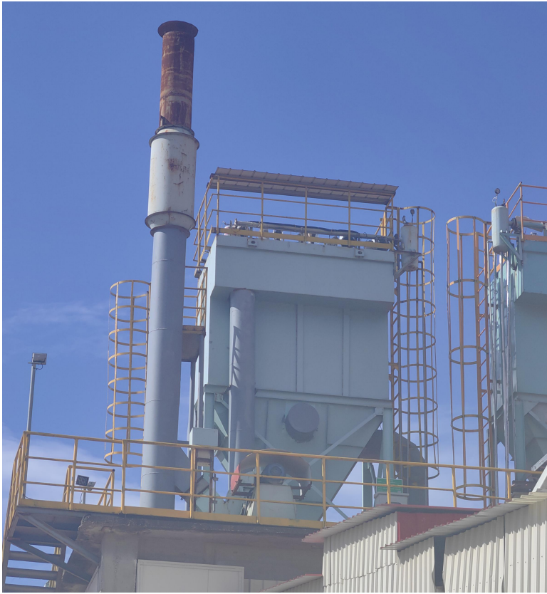
废气处理设施
