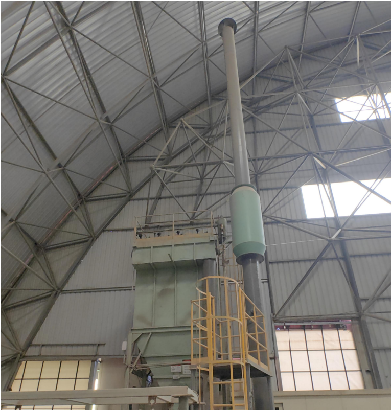
废气处理设施
