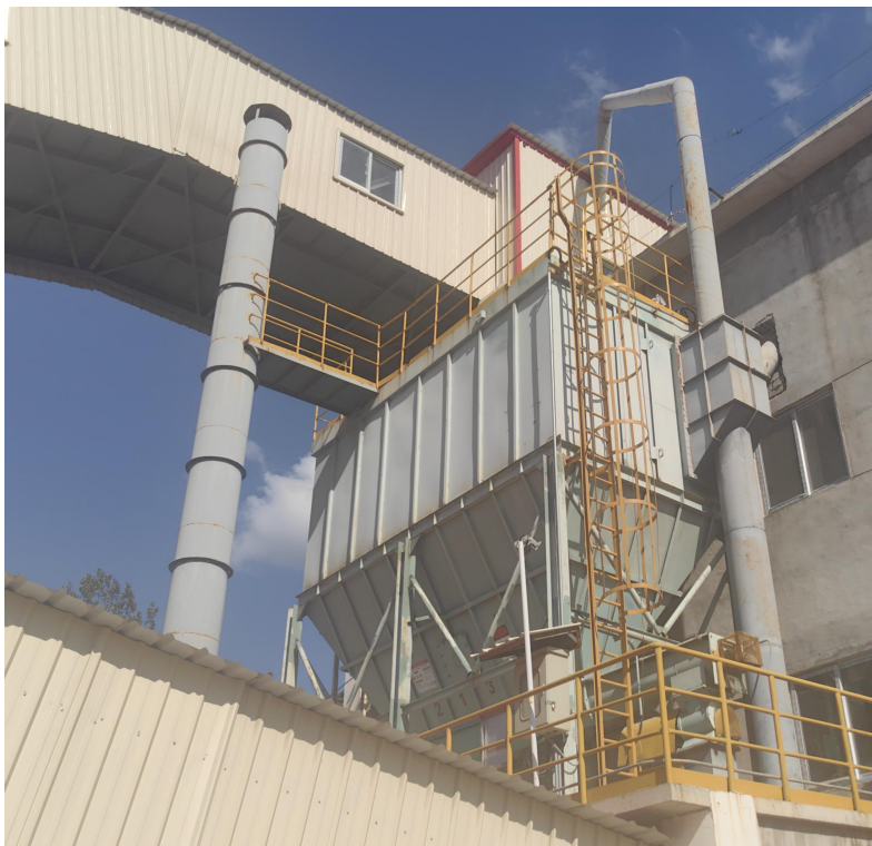
废气处理设施
