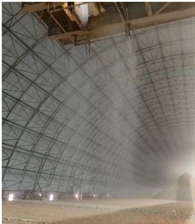
成品储存干雾抑尘装置
