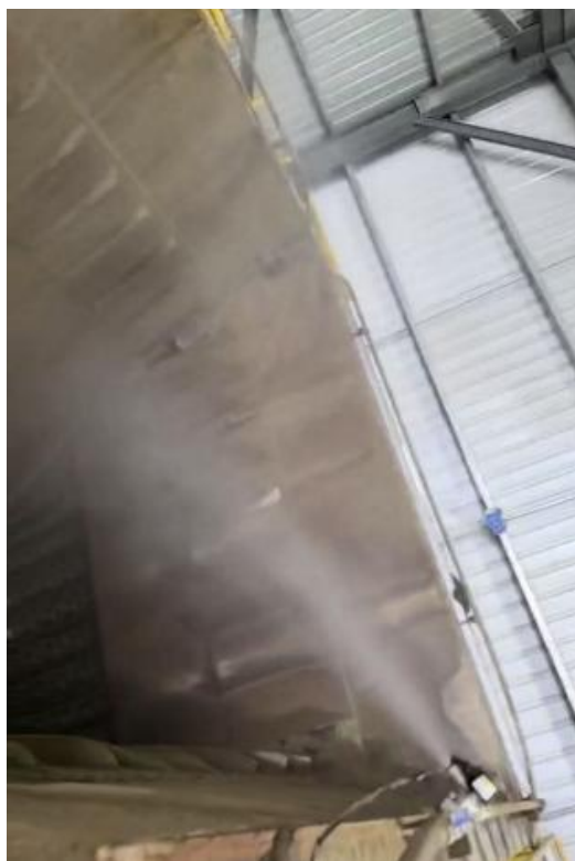
卸料区域干雾抑尘装置
